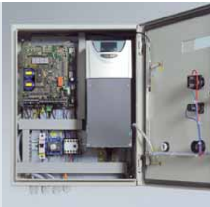
Deschidere automată prin USV Eliberează căile în cazul căderilor de curent.
